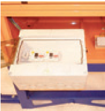
Technik-Schließfach mit Sicherungskasten
